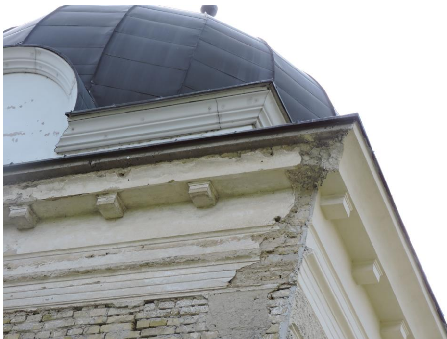
Детаљ поткровног венца изнад мртвачнице са оштећењима
