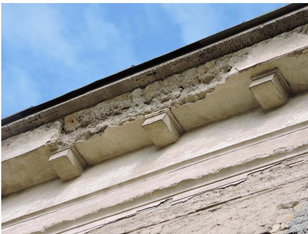
Детаљи поткровног венца са оштећењима изнад стана домара
